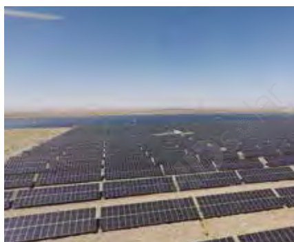
設置現場: 甘粛省 アクス 架台種類: 野立て固定式 設置時間: 2020年3月 設置容量: 10MW
