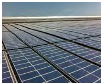
設置現場: フィリピン 架台種類: 陸屋根置き型架台システム 設置時間: 2016年12月 設置容量: 500KW
