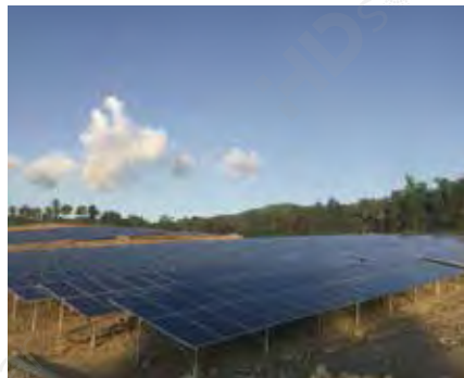
設置現場:フィリピン ロンロン 架台種類:地上設置型架台システム 設置時間:2018年6月 設置容量:7.6MW
