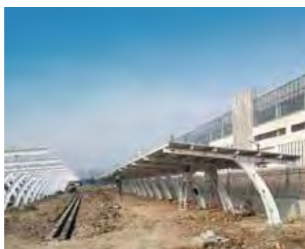
設置現場: 寧波 梅橋 架台種類: ソーラーカーポート 設置時間: 2018年9月 設置容量: 377.6KW
