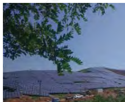
設置現場: 山西 垣曲 架台種類: 地上設置型架台システム 設置時間: 2018年4月 設置容量: 10MW
