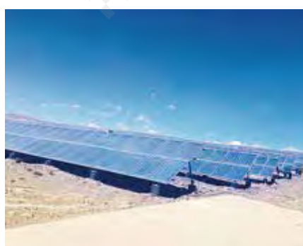
設置現場: 山西 大同 架台種類: 地上設置型架台システム 設置時間: 2014年12月 設置容量: 50MW
