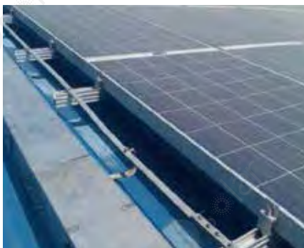
設置現場: チリ 架台種類: 折板屋根置き型架台システム 設置時間: 2017年4月 設置容量: 300KW
