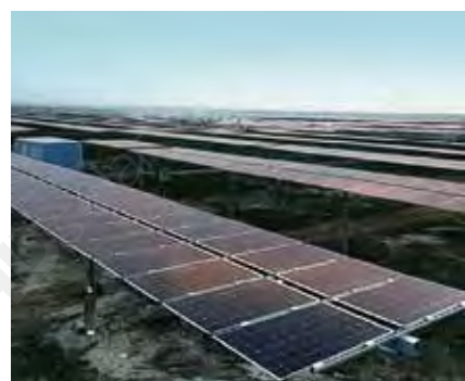
設置現場: 浙江 舟山 架台種類: 単軸式追尾架台システム 設置時間: 2017年6月 設置容量: 130KW
