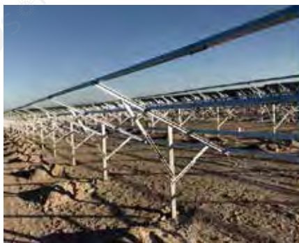
設置現場:メキシコ 架台種類:地上設置型架台システム 設置時間:2018年10月 設置容量:1.02MW
