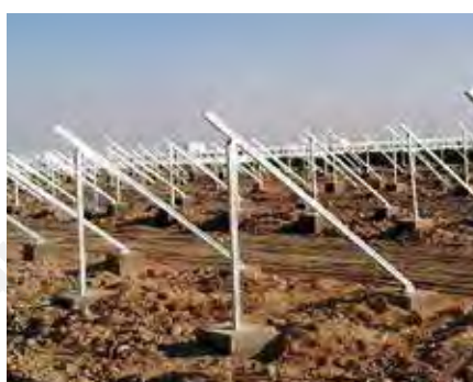
設置現場: 甘肅 嘉峪関 架台種類: 地上設置型架台システム 設置時間: 2014年6月 設置容量: 30MW
