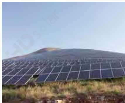
設置現場: 河北 ライ源 架台種類: 地上設置型架台システム 設置時間: 2017年5月 設置容量: 20MW
