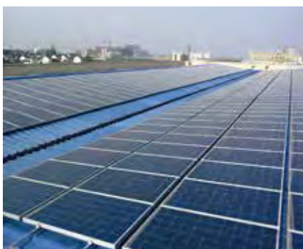
設置現場: アルゼンチン 架台種類: 折板屋根置き型架台システム 設置時間: 2017年12月 設置容量: 221.6KW
