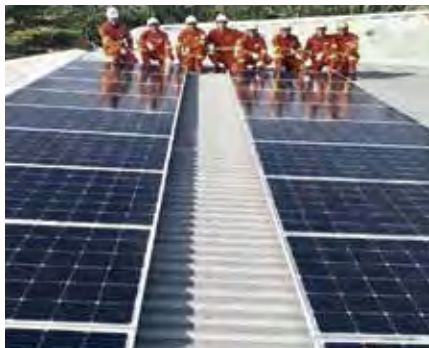
設置現場:ベトナム HCMC 架台種類:折板屋根置き型架台システム 設置時間:2018年7月 設置容量:700KW
