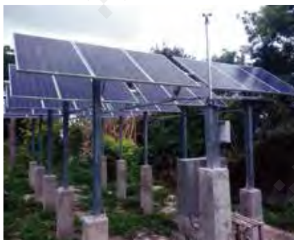
設置現場: フィリピン 架台種類: 単軸式追尾架台システム 設置時間: 2017年1月 設置容量: 20KW
