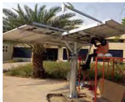
設置現場: サウジアラビア 架台種類: 二軸式追尾架台システム 設置時間: 2015年12月 設置容量: 20KW
