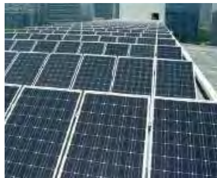
設置現場: アフガニスタン 架台種類: 陸屋根置き型架台システム 設置時間: 2017年12月 設置容量: 300KW
