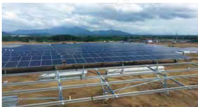
設置現場:ベトナム ニャチャン 架台種類:地上設置型架台システム 設置時間:2018年11月 設置容量:50MW
