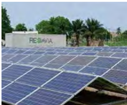
設置現場: ガーナ 架台種類: 折り畳み架台システム 設置時間: 2017年12月 設置容量: 316.8KW
