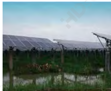
設置現場: 浙江 楽清 架台種類: 地上設置型架台システム 設置時間: 2017年4月 設置容量: 50MW
