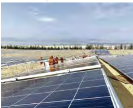
設置現場:ベトナム ビンディン 架台種類:地上設置型架台システム 設置時間:2018年9月 設置容量:50MW
