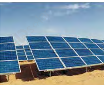
設置現場: 陝西 西安 架台種類: 地上設置型架台システム 設置時間: 2014年4月 設置容量: 150MW
