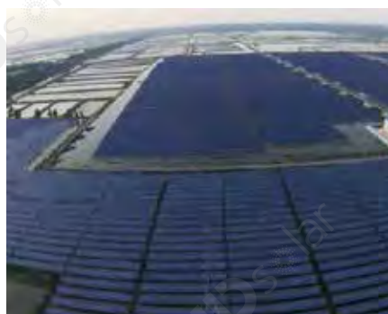
設置現場: 江蘇 興化 架台種類: フロート式架台システム 設置時間: 2015年5月 設置容量: 80MW
