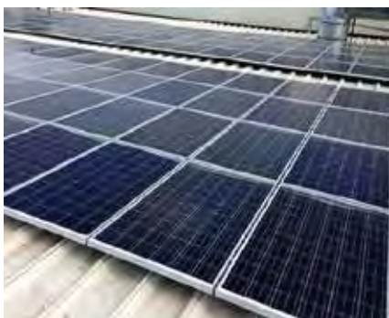
設置現場: エジプト 架台種類: 折板屋根置き型架台システム 設置時間: 2016年11月 設置容量: 300KW
