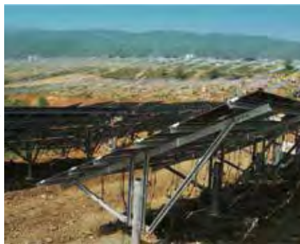
設置現場: 遼寧 錦州 架台種類: EPCプロジェクト 設置時間: 2017年5月 設置容量: 15MW
