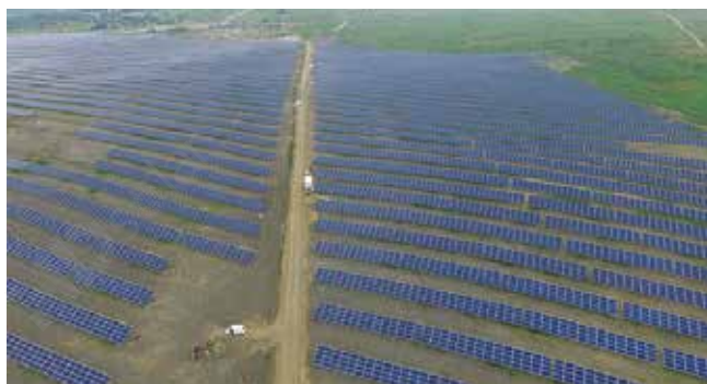
設置現場:ウクライナ 架台種類:地上設置型架台システム 設置時間:2019年10月 設置容量:114MW
