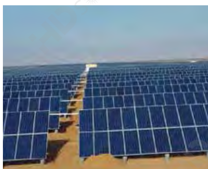
設置現場: 内モンゴ 架台種類: 地上設置型架台システム 設置時間: 2015年8月 設置容量: 100MW
